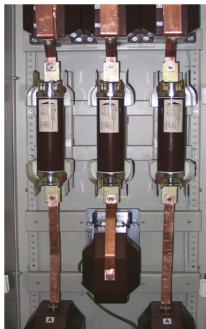
Konekcija u unutrašnjem prekidaču, primjer:
